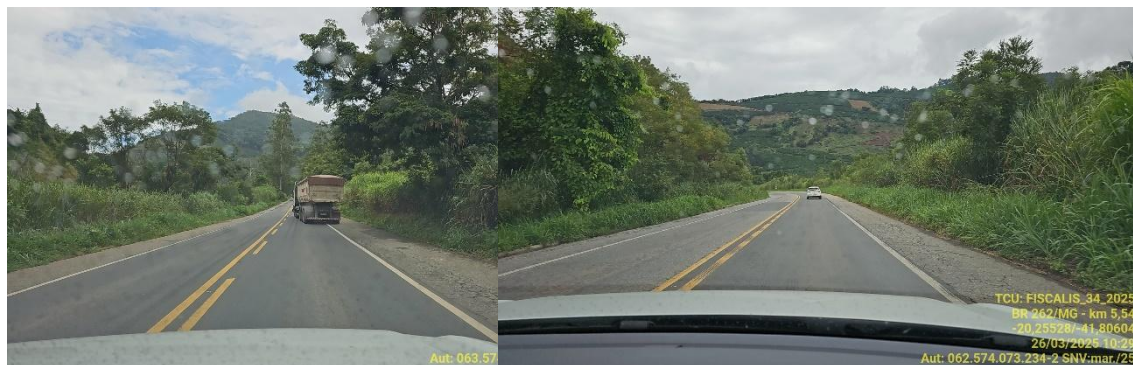
Figura 7 - Trincas no acostamento ao lado de segmentos nos quais já houve intervenção funcional
